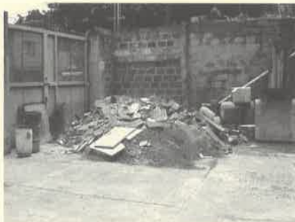
Imagen 5. Escombros generados en empresa de prefabricados. Medellín, Antioquia.
