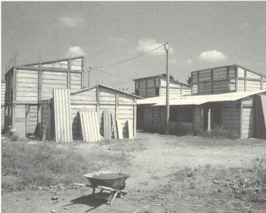
Imagen 7. Panorámica de instalación de prefabricados confeccionados con eco-cemento proveniente del reciclaje de cenizas volantes de hornos industriales. Palmira, Valle del Cauca.
